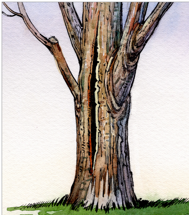
Tronco agrietado de caducifolio
